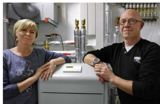
Daniela und Frank Freitag in ihrem Technikraum im Dynahaus: Die WPL 15 IS-2 ist so leise, dass man sie im benachbarten Wohnzimmer fast vergisst.
