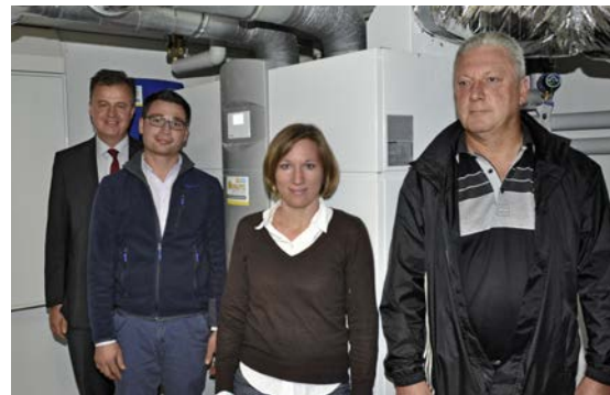
Vier, die mit der Anlage zufrieden sind: WuM-Geschäftsführer Werner Müller, Bauherrin Dagmar Lange, Markus Schlotz von der Schlotz GmbH und Rolf Kirchner von STIEBEL ELTRON (v. r.).
